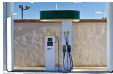
水素ステーション
