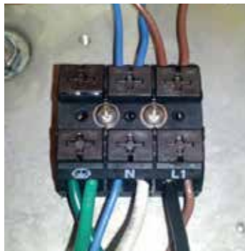
（写真1）配線端子台
